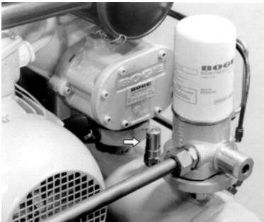
Bild 3.42: Sicherheitsventil am Schraubenkompressor
