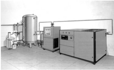
Bild 8.8 : Kompressorstation mit Schraubenkompressor, Kälte-Drucklufttrockner, Druckluftbehälter und Filtersystem
